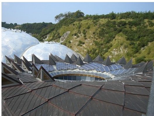
写真5. 屋根に設置されたソーラーシステム
